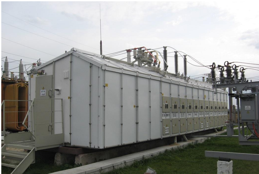
Рисунок 2 – Комплектное распределительное устройство наружной установки
