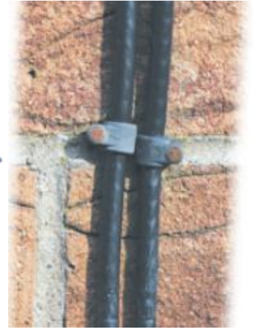
Рисунок 7 – Кабель, прикрепленный к стене при помощи электроустановочной скобы
